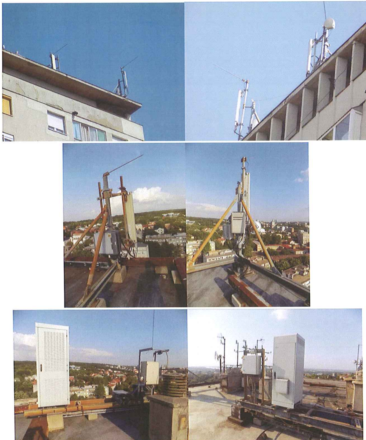
Slika 2.3. Fotografije antenskih sistema i baznih stanica Telekoma i Vip mobile na krovu predmetnog objekta
