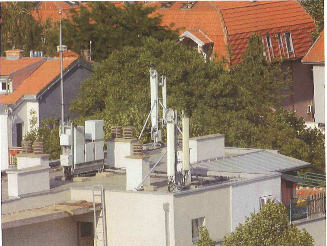
Slika 2.4. Fotografije antenskog sistema i bazne stanice operatera Telenor u krugu 150m od predmetnog objekta – slikano sa krova predmetnog objekta
